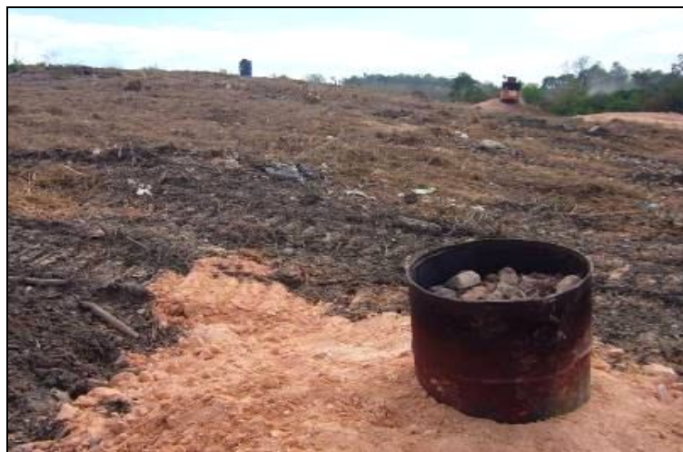
Figura 19: Drenos de biogás.
