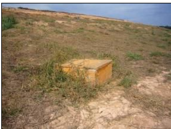
Figura 15: Caixa de monitoramento de percolado.
