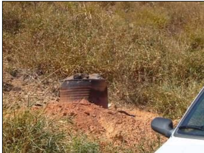
Figura 28: Dreno de biogás.
