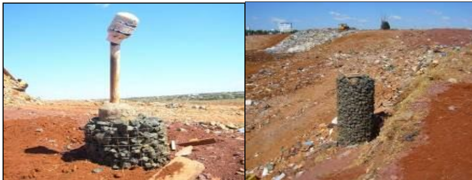
Figura 41: Drenos de gás com queimador, dispostos no aterro
