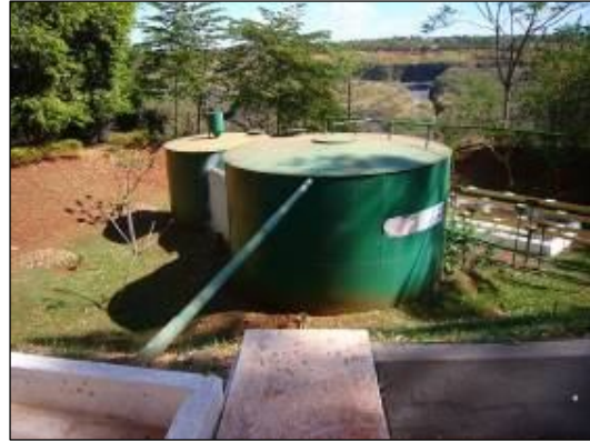
Figura 43: Reator anaeróbico para tratamento do percolado.
