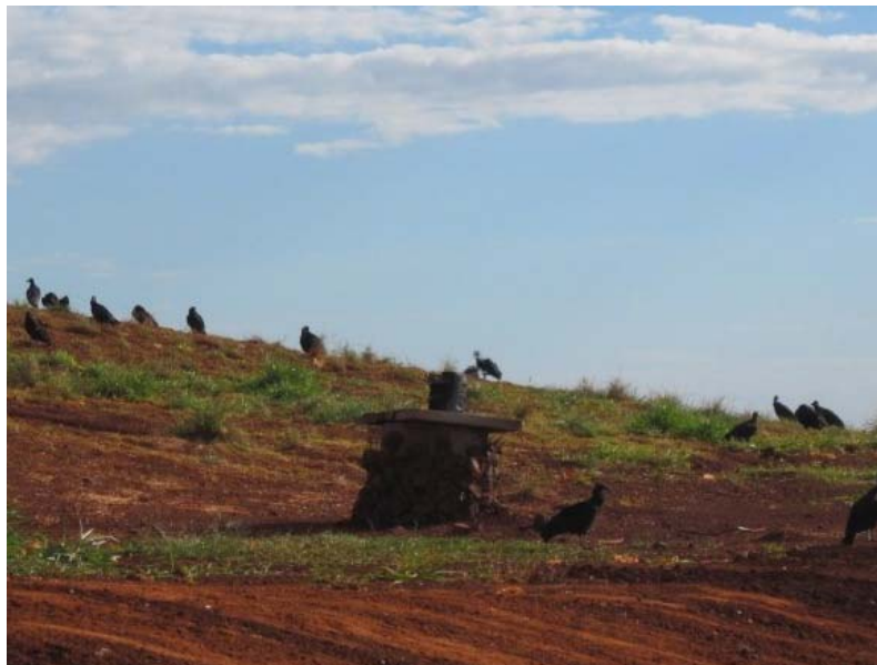
Figura 10. Poço de Dreno com Queima de GAS
