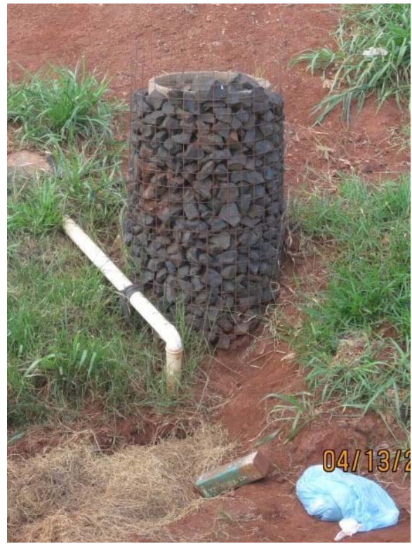
Figura 9. Poço de Dreno com Gaiola
