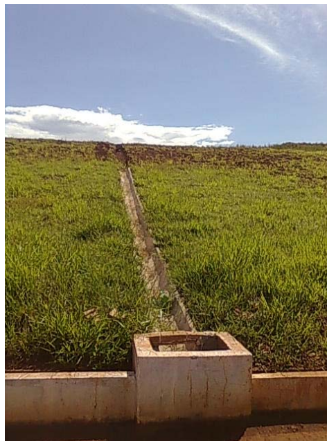
Figura 6. Trincheiras de Drenagem de Chorume
