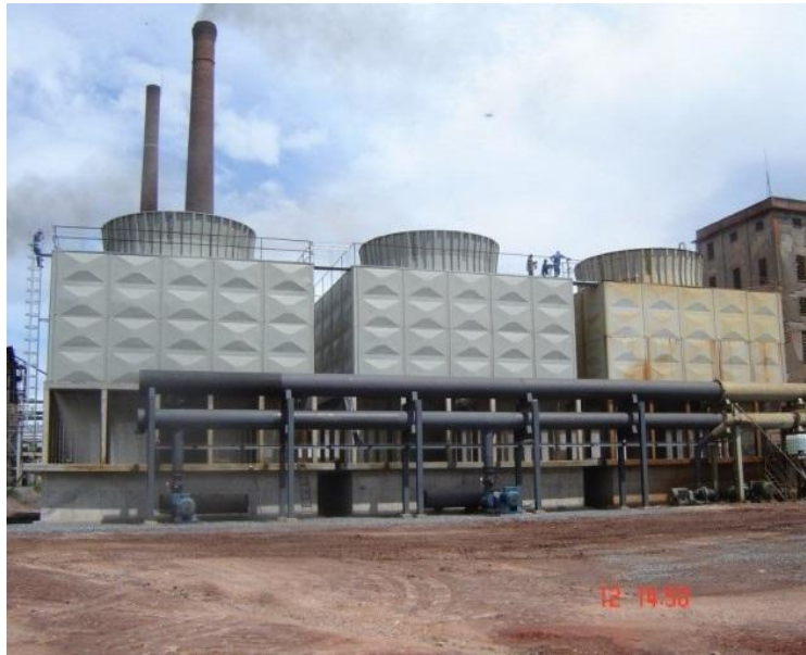
Figura 1: Resfriadores de água e tubulação de recirculação
