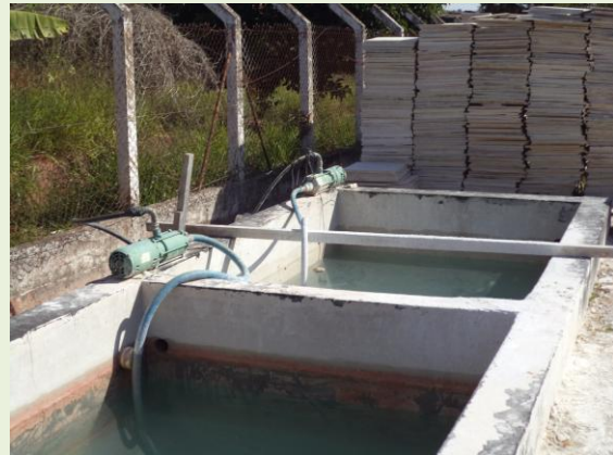
Figura 8 – Novo sistema de bombeamento
