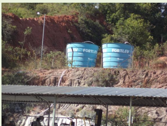
Figura 5 – Caixas de água, implantadas no teto do galpão, para alimentação das serras por gravidade
