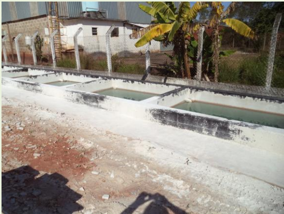
Figura 7 – Nova sequência de câmaras de decantação dos efluentes
