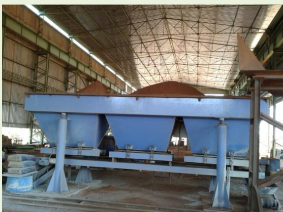
Foto 09 - Silo de armazenamento da areia, utilizada na fabricação dos blocos.
