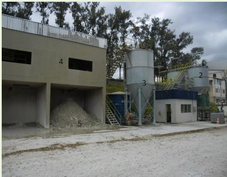
Foto 03 - Vista geral da ETE - Estação de Tratamento de Efluentes, e da Infraestrutura implantada. Pontos 1 - Tanque para homogeneização, 2 - Tanque de decantação, 3 - Tanque de clarificação, 4 - Infraestrutura e 5 - material estocado. (Fonte CECRISA)
