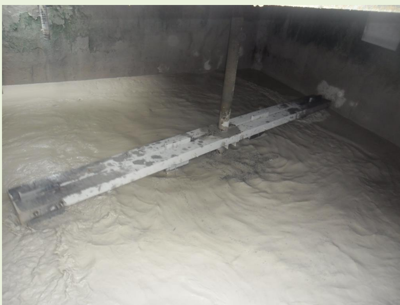
Foto 01 - Tanque para homogeneizar e adicionar fluoculante ao efluente industrial (Fonte: CECRISA)
