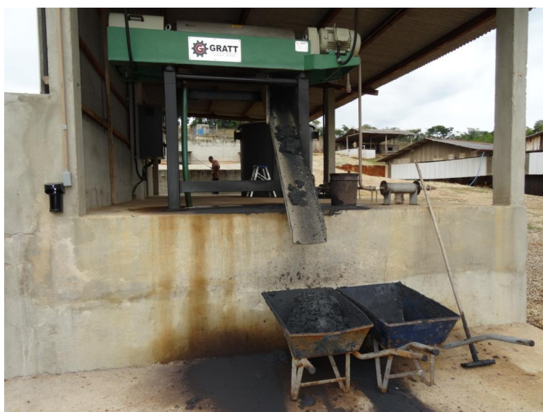
Figura 8 – Desidratação do lodo da estação de tratamento
