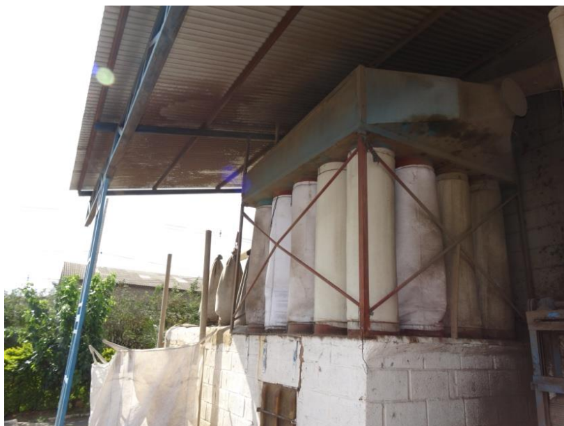
Figura 14 – Instalação com filtro manga para controle de material particulado da etapa de lixamento de couros
