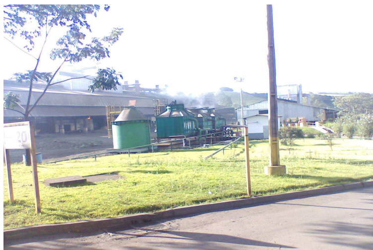
Figura 3.9 - Torre de resfriamento da água
