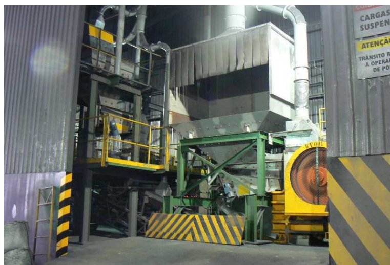
Figura 3.5 - Britador de ferro-silício contemplado com sistema de exaustão
