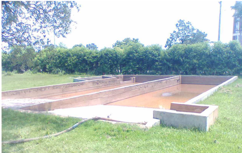
Figura 3.10 - Tanque de decantação da água de lavagem de quartzo
