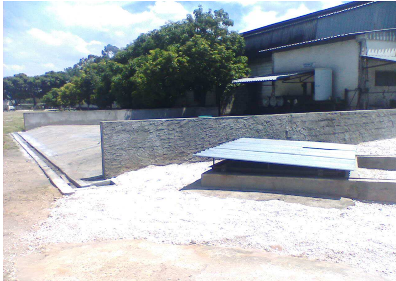
Figura 3.12 - Área de lavagem de veículos com caixa separadora de óleo/água
