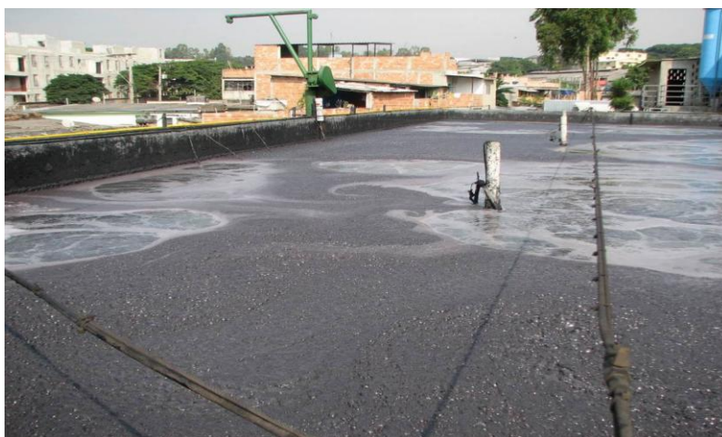
Figura 16 – Reator biológico com aeração
