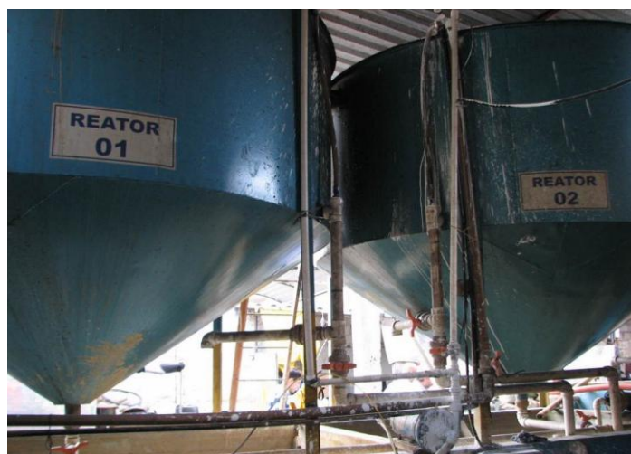
Figura 10 – Tanques de decantação
