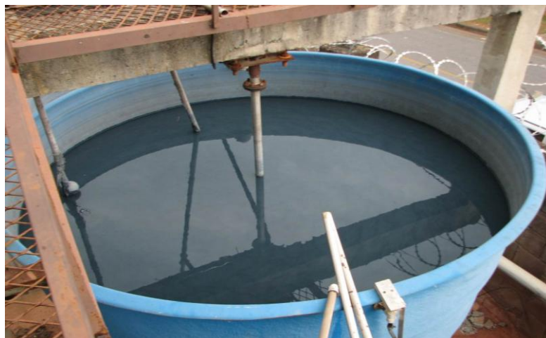
Figura 13 – Tanque de decantação
