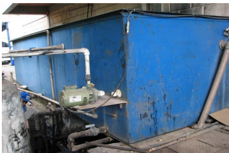
Figura 11 – Tanque de flotação e decantação
