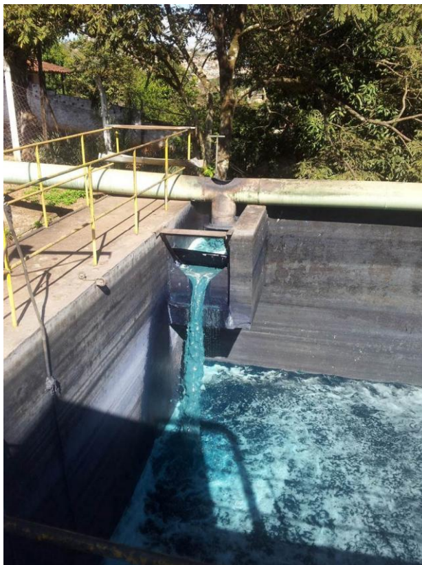
Figura 15 – Tanque de homogeneização
