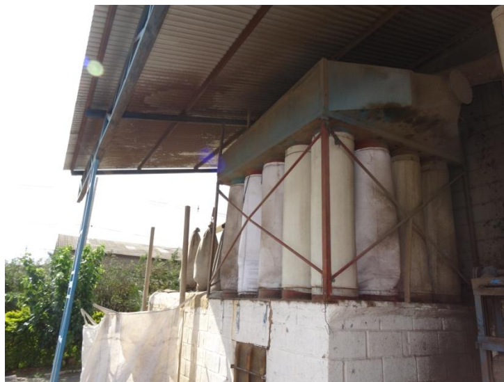
Figura 12: Instalação com filtro manga para controle de material particulado da etapa de lixamento de couros
