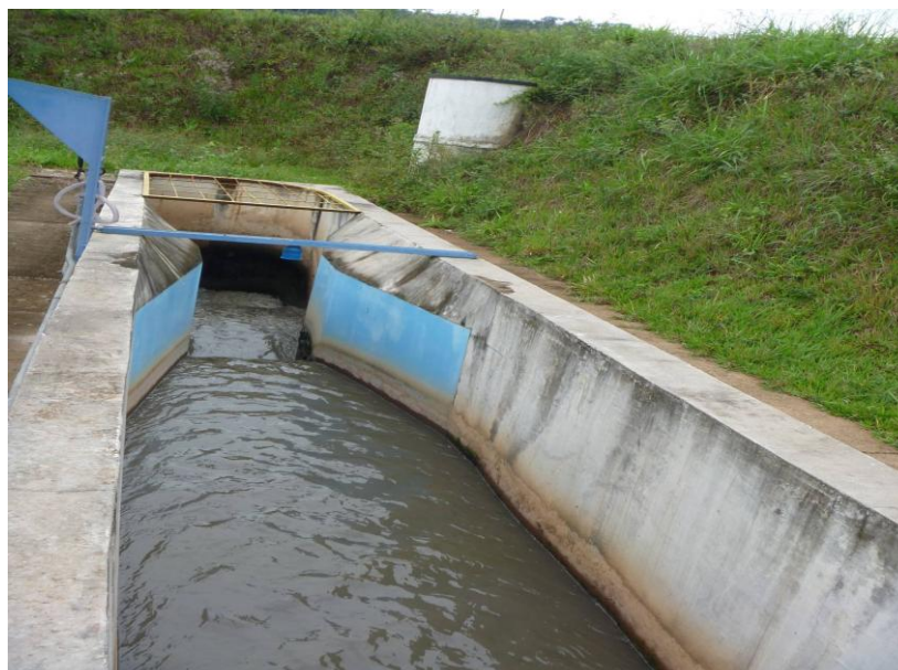
Figura 5-3 – Calha Parshall – ETE Laboreaux, Itabira/MG.
