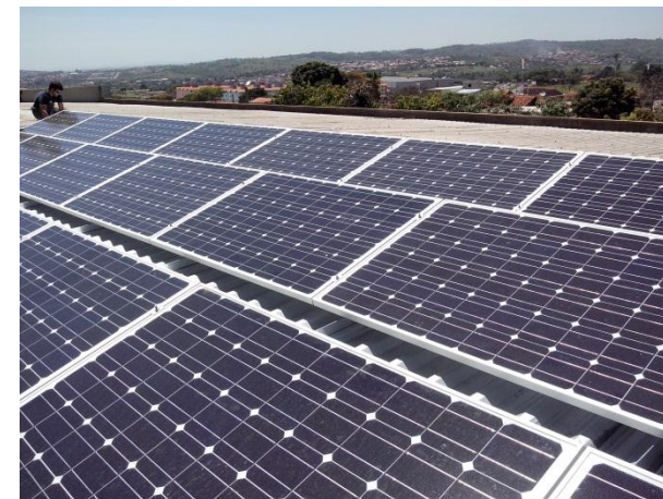
Vista do campo gerador sobre o telhado do Prédio 2 da UNIFEMM.
