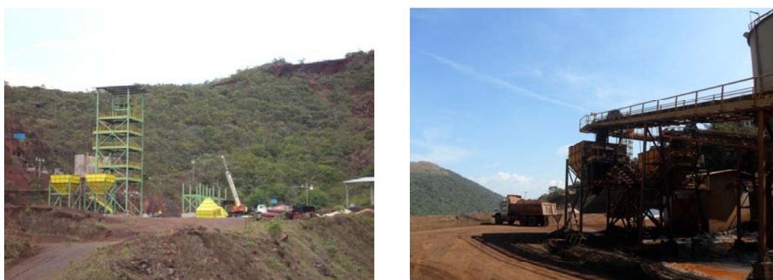
Figura 36 Instalação e Operação da UTM Fonte: FEAM, 2006 / YKS, 2011
