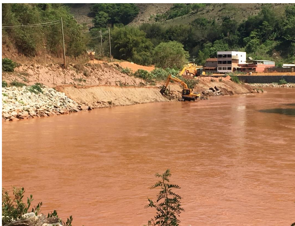
Foto 22: Planta G006900-C-100330 (folha 6/16) _TR 15. Máquina fazendo a reconformação do talude marginal da margem esquerda do rio do Carmo.
