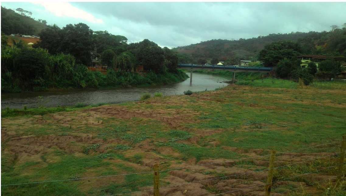
Foto 29: Ravinamento margem direita.
