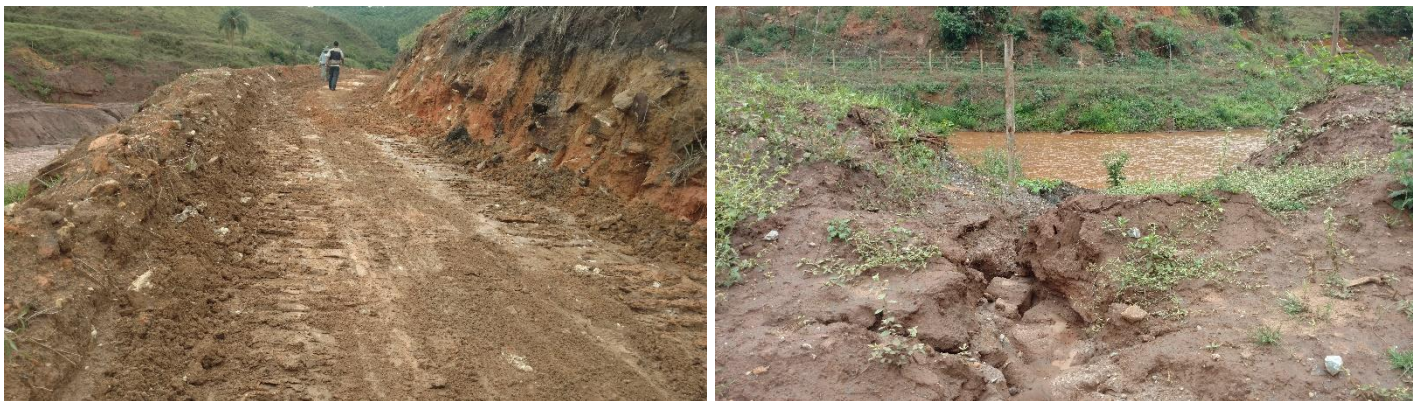
Figura 7: Condições das estradas de acesso: observa-se taludes expostos e falta de drenagem, trechos TR08-306 e TR08-310 respectivamente.
