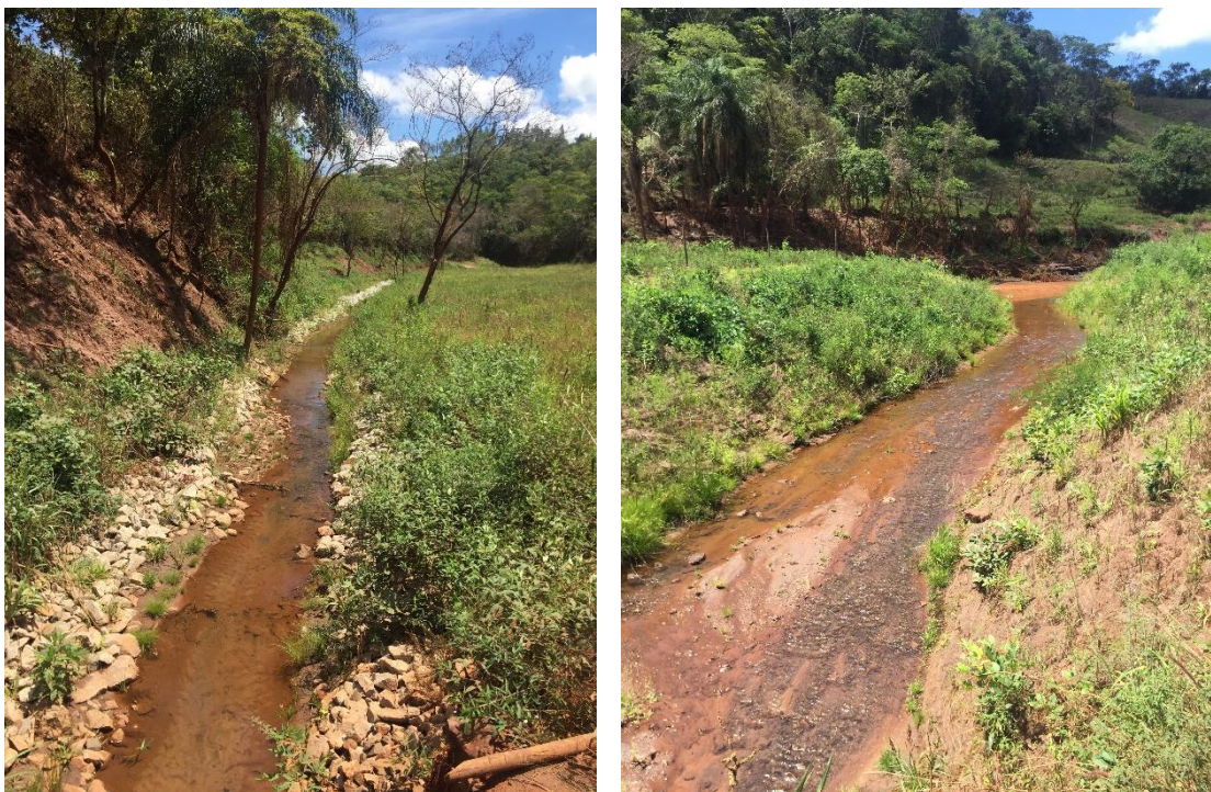
Foto 4. A e B: Tributário TG-30 com obras deficientes.
