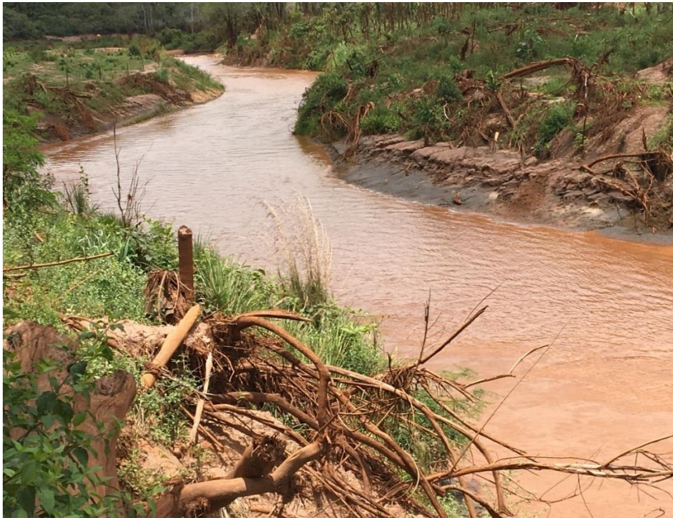
Foto 09: Ponto 03_TR 09. Vista das margens com árvores mortas com o mix de vegetação lançado nessas margens de forma emergencial. Este trecho observa a instalação de processo erosivo e carreamento de sedimentos para a calha do rio.
