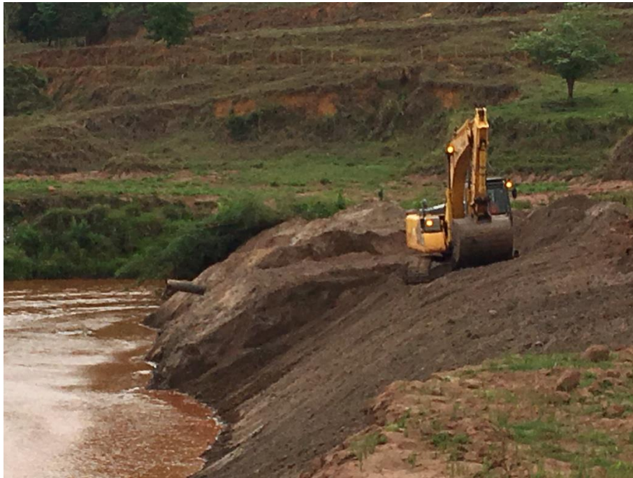
Foto 05: Ponto 04_TR 15. Obras de reconformação do talude marginal, coordenadas UTM: 702.920, 7.755.812, zona 23 K, Datum SAD 69.
