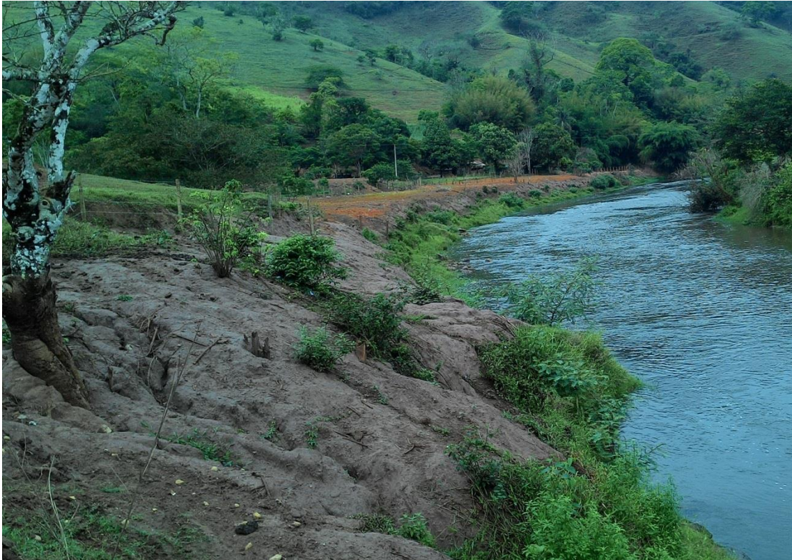
Foto 28: Ravinamento margem direita.
