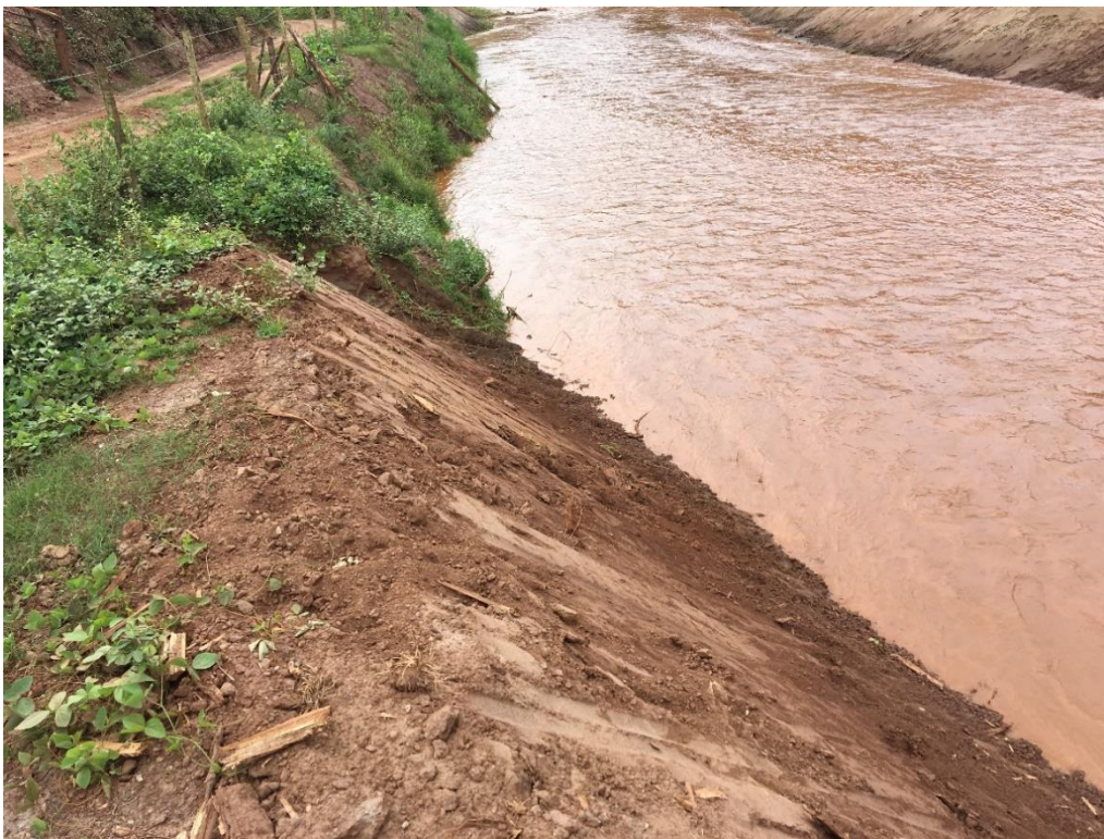
Foto 08: Ponto 02_TR 09. Vista do talude da margem esquerda do rio Gualaxo Norte em que foi reconformado com a retroescavadeira, evidenciando a altura, a inclinação, bem a falta de vegetação. Este trecho potencial local de instalação de processo erosivo e carreamento de sedimentos para a calha do rio.
