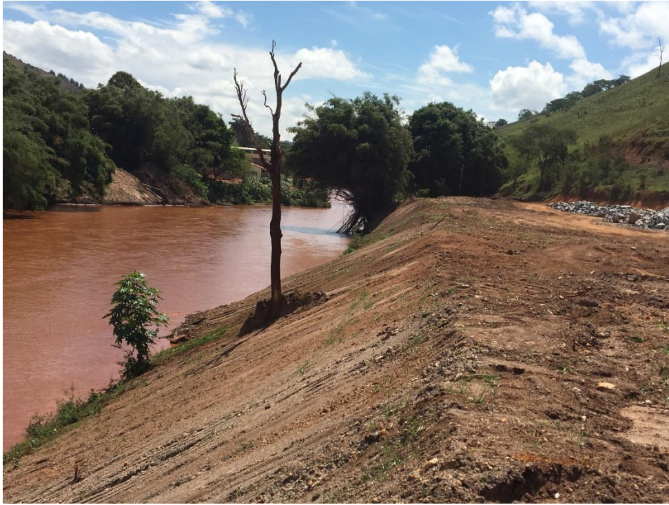
Foto 20: nas imediações do Ponto 09_TR 15. Vista de um talude marginal reconformado e desprotegido de vegetação susceptível a instalação de processos erosivos.
