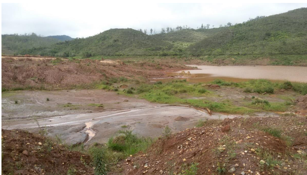
Foto 3: Intenso processo erosivo na margem direita.
