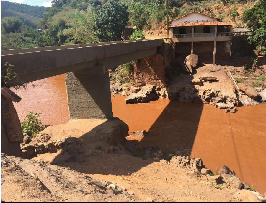
Foto 25: Planta G006900-C-100330 (folha 6/16) _TR 15. Vista geral da ponte assentada sobre o afloramento rochoso.
