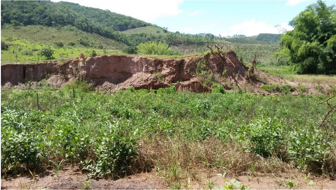
Foto 6: Talude com processos erosivos.
