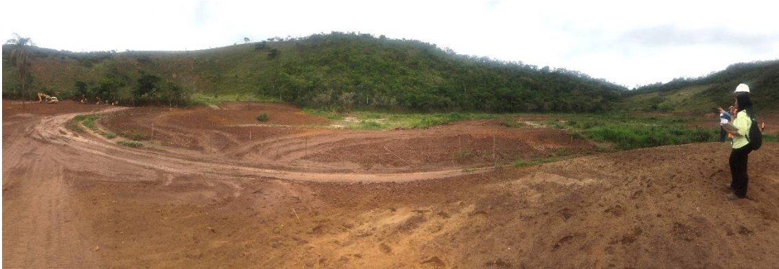
Foto 10: Lagoa preenchida com rejeito que foi cercada.
