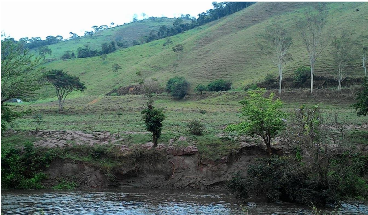
Foto 32: Ravinamento e deslizamentos na margem esquerda.
