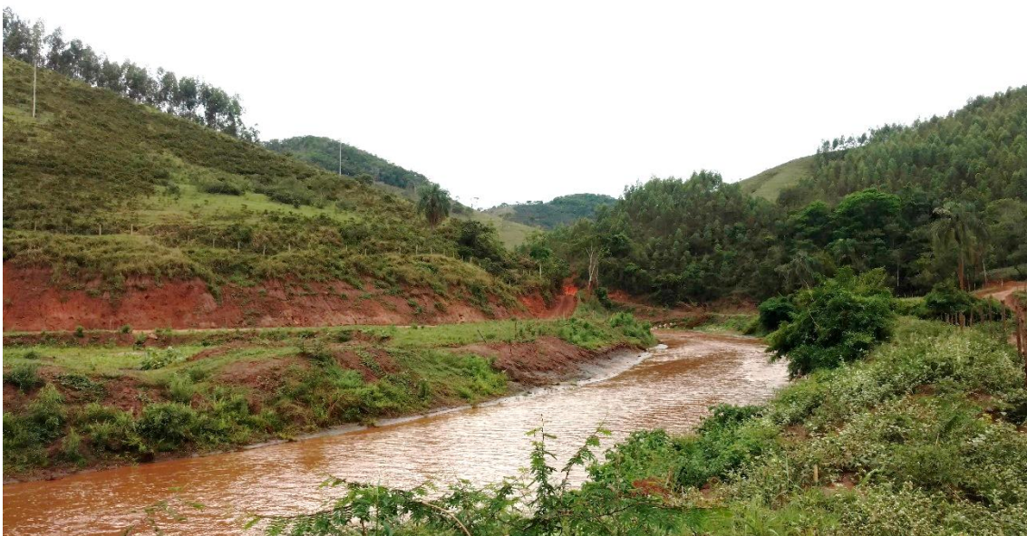
Figura 09: Visão geral das margens do rio no TR08-309. Observa-se drenagem para escoamento de água da estrada sem proteção e erodida no primeiro plano e o talude da margem esquerda, em detalhe, com solo exposto em algumas áreas.
