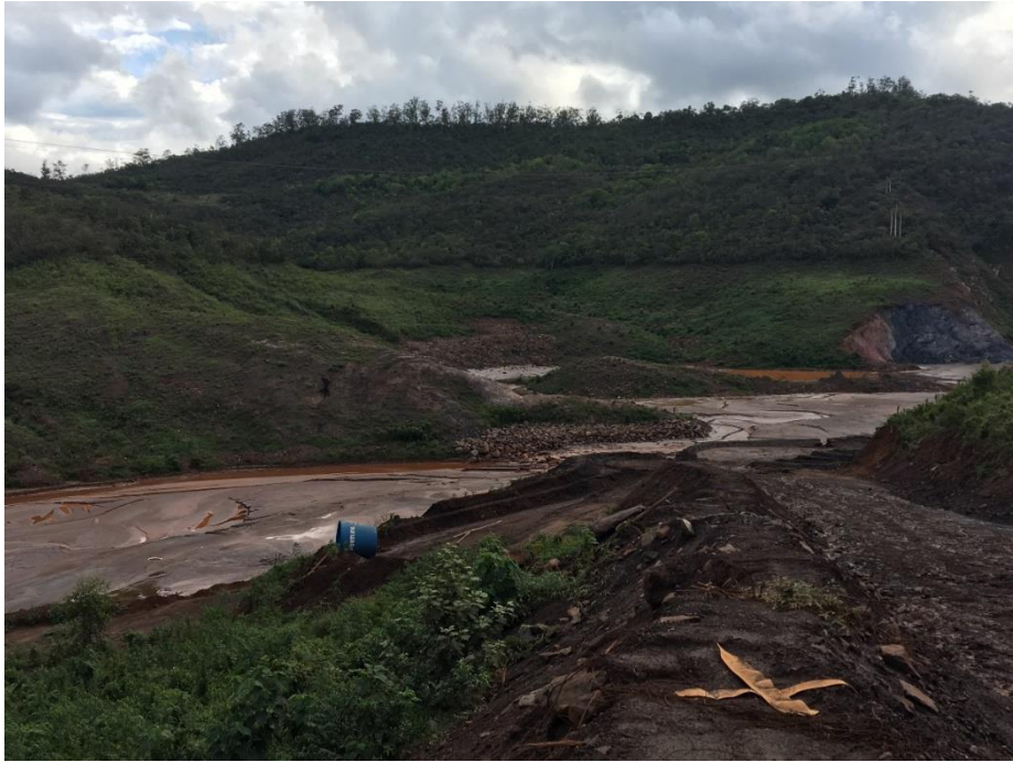
Foto 03: Ponto 02_TR 10. Vista geral do da área do dique S2 que se encontra totalmente assoreado, coordenadas UTM 663.423 / 7.776.872, zona 23 K, Datum SAD 69. A margem direita observa-se uma área de acesso até a estrutura, material susceptível a erosão e APP impactada.
