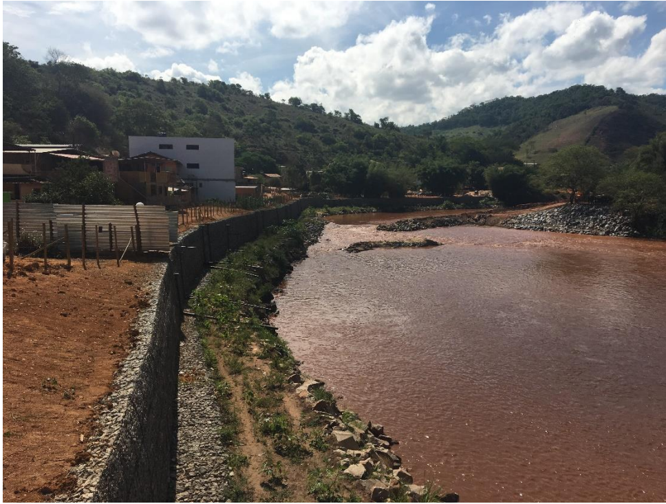
Foto 23: Planta G006900-C-100330 (folha 6/16) _TR 15. Construção de muro de gabião na margem direita do rio do Carmo.
