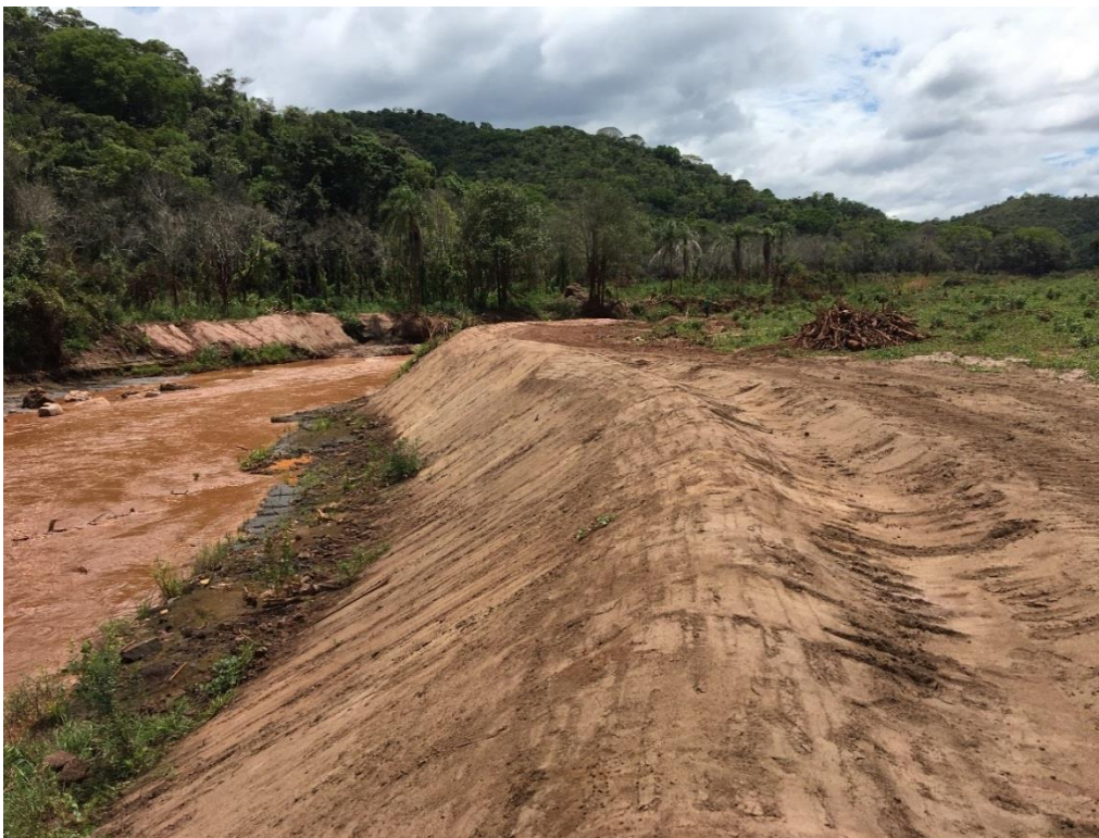
Foto 10: Ponto 03_TR 09. Vista da margem direita que já foi reconformada e que recebera a biomanta. Observa-se uma depressão nessa reconformação onde será direcionada a água de chuva e conduzida para o rio.
