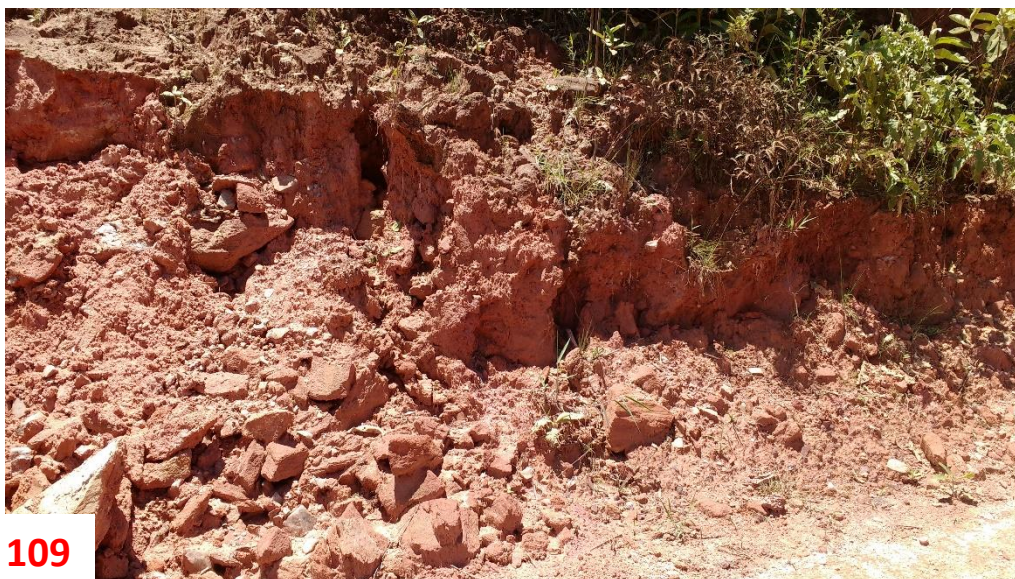
Figura 109: Desmoronamentos em vias de acesso anteriormente utilizadas.
