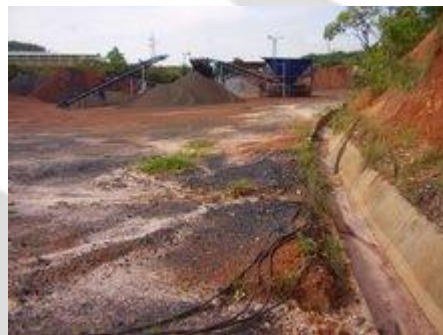
Foto 3 – Canaletas de condução das águas pluviais que circunscrem o pátio de estocagem de minério.
