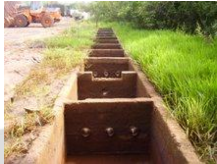
Foto 4 – Tanques de sedimentação das águas pluviais.
