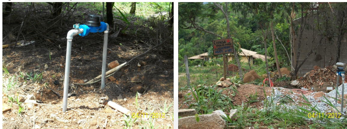
Fotos 9,10: Cavaletes com medidor de água.
