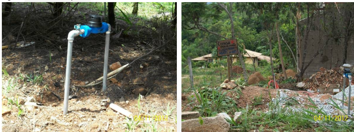
Fotos 9,10: Cavaletes com medidor de água.
