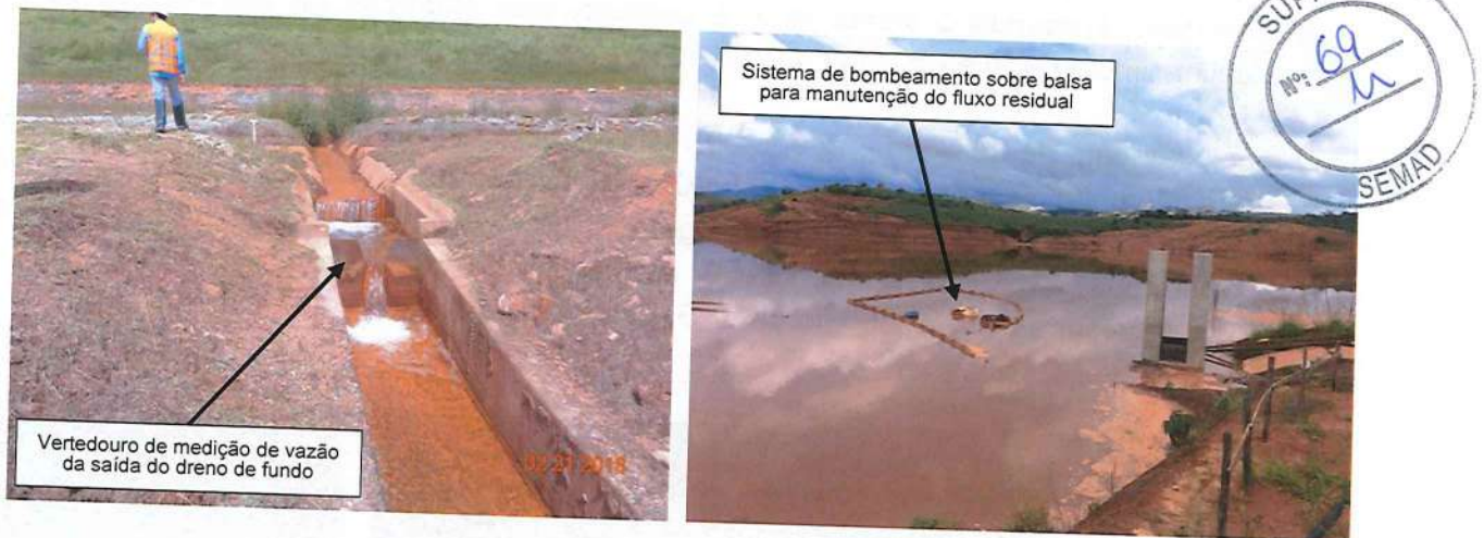
Figura 3.11 - Dispositivos de manutenção do fluxo residual a jusante da Barragem de Rejeitos.
