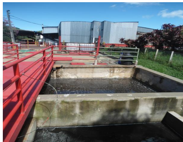
Foto 04. Estação de Tratamento de Efluentes - ETE
