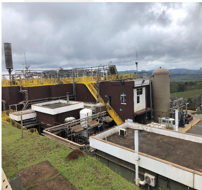
Foto 03. Vista geral da ETE.
