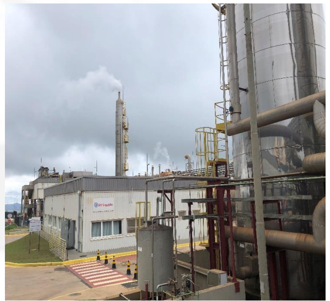
Foto 04. Unidade de cogeração operada pela empresa Air Liquide.
