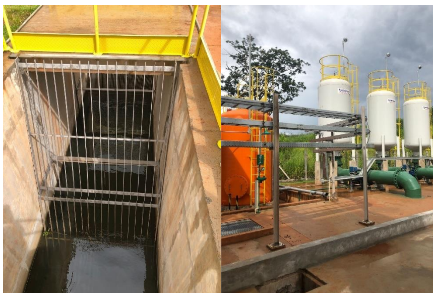
Figura 2-3 Gradeamento e tratamento de água captada
