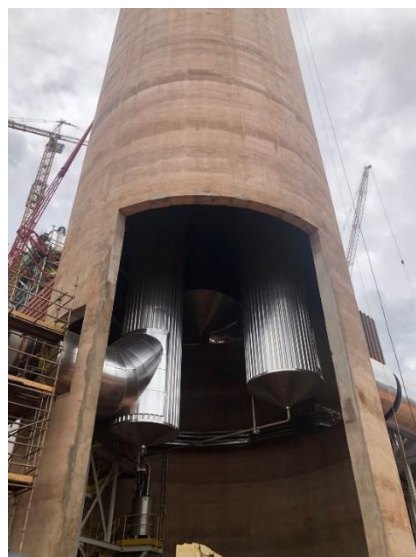
Figura 2-5 Saída unificada das chaminés
