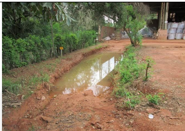
Foto 10: Bacia de contenção de água pluvial
