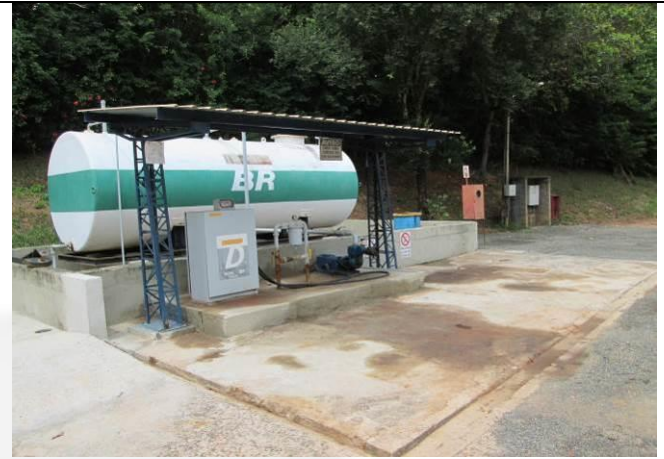
Foto 4: TAC com piso impermeabilizado e canaletas de coleta de óleo
