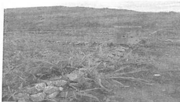
Figura 07: Sistema de drenagem dos gases na base da área de aterragem do aterro sanitário (3ª etapa).
