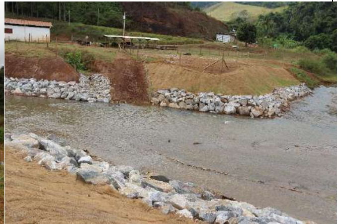
Foto 27: Rampa para utilização da margem para dessedentação animal entre enrocamento nas margens dos tributários
