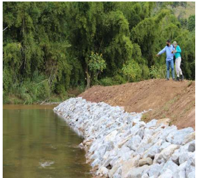
Foto 29: Detalhe do contraste entre turbidez da água do rio Gualaxo e do tributário e obras de enrocamento na margem do tributário
