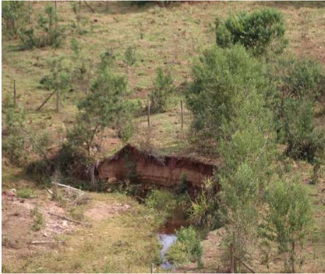
Foto 30: Processos erosivos nas margens do tributário.
