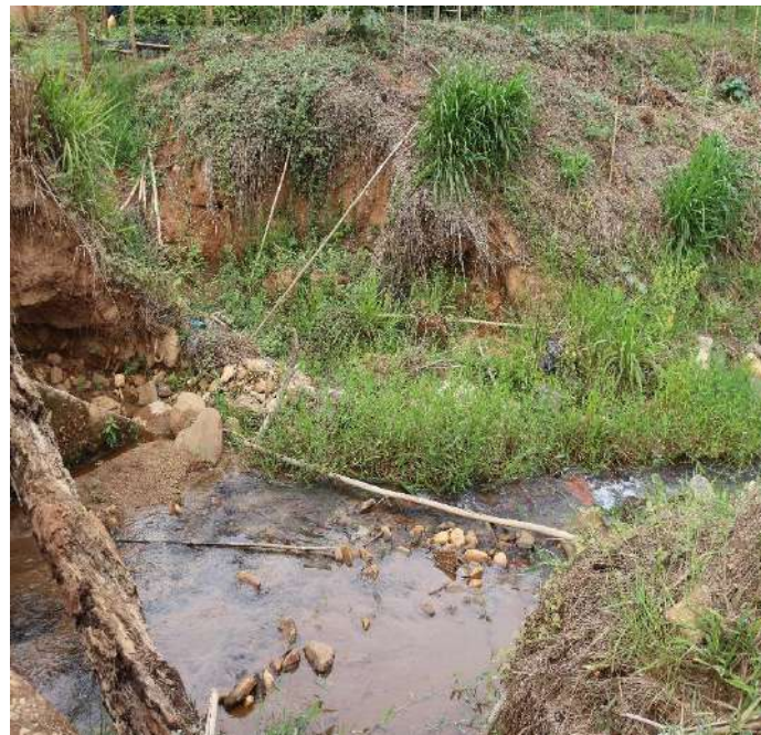
Foto 25: Área erodida com necessidade de recomposição das obras de bioengenharia
