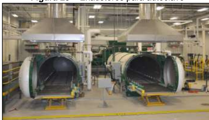
Figura 29 – Exaustores para autoclave
