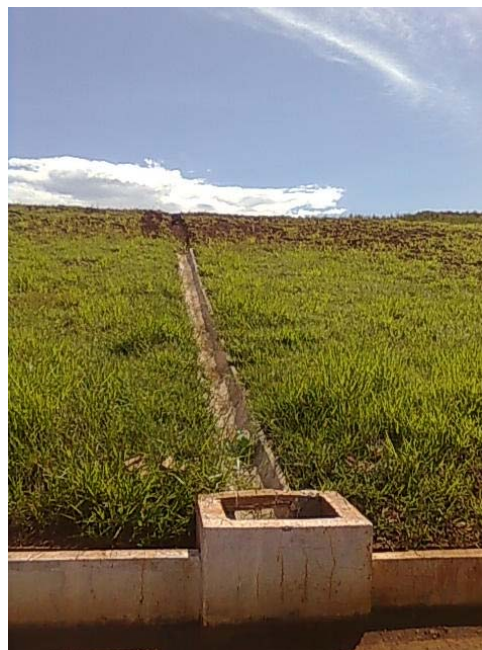
Figura 6. Trincheiras de Drenagem de Chorume
