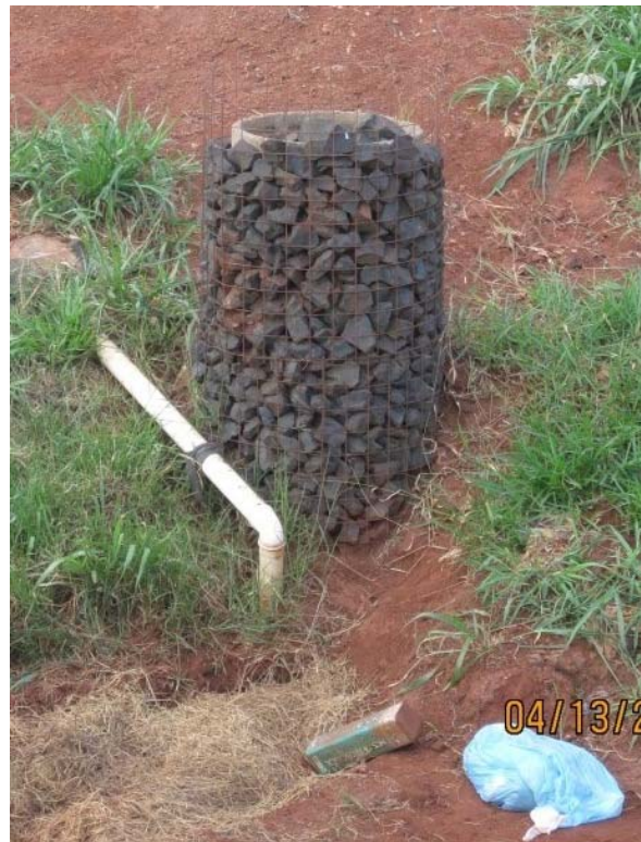
Figura 9. Poço de Dreno com Gaiola
