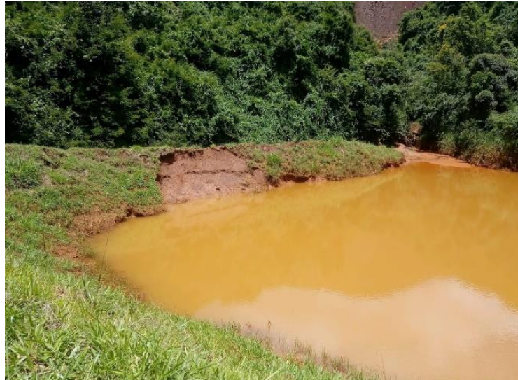
Figura 24: Indício de movimentação de massa no talude de montante da barragem. Fonte: Acervo Feam.
