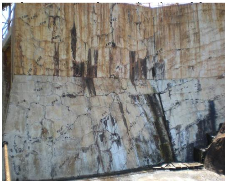
Figura 39: Fissuras no paramento provocadas por reação álcali agregado. Fonte: Cardia e Kuperman, [201-].
