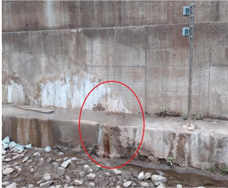
Figura 40: Surgência através de uma fissura no paramento. Fonte: Acervo Feam.
