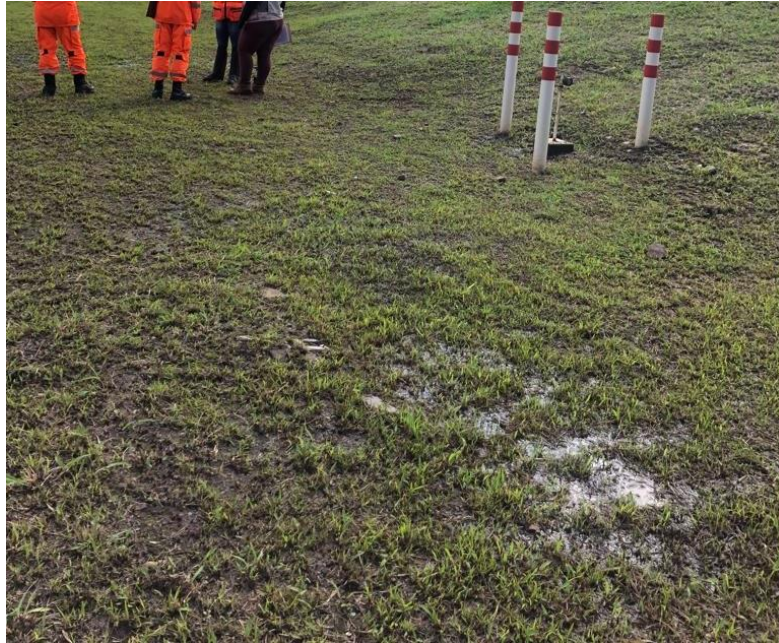
Figura 31: Saturação superficial no maciço. Fonte Acervo Feam.
