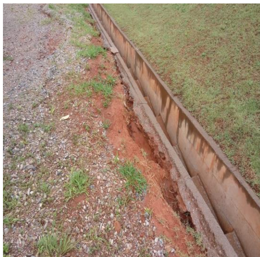
Figura 47: Contato erodido entre o maciço e a canaleta de drenagem. Fonte: Acervo Feam.
