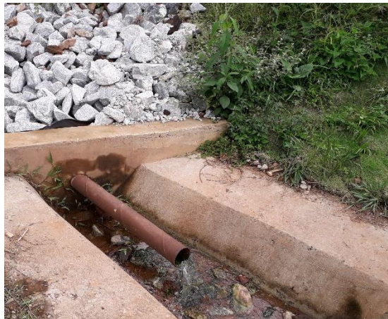
Figura 33: Surgência tratada no talude de uma barragem de terra. Fonte: Acervo Feam.
