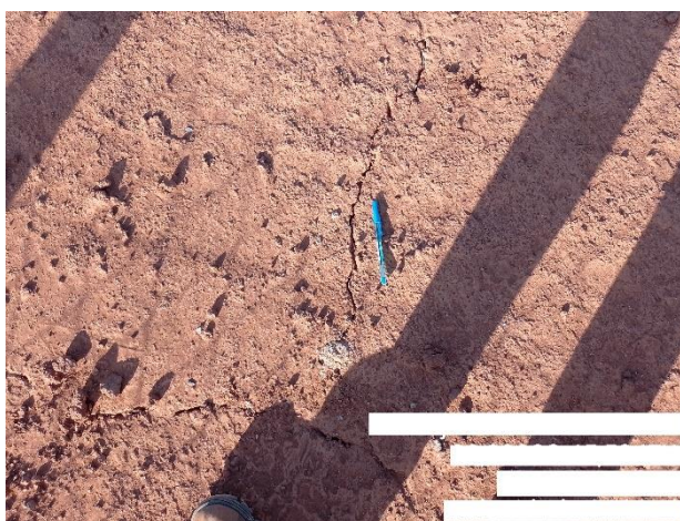
Figura 26: Fissuras por ressecamento na superfície do maciço. Fonte: Acervo Feam.
