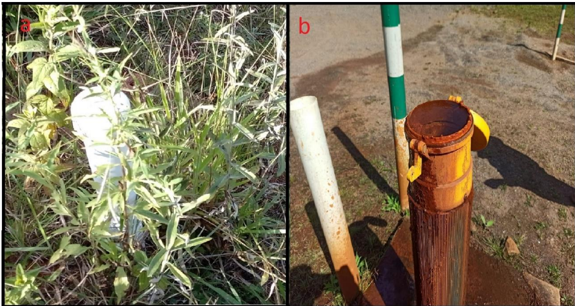
Figura 51: Deterioração na instrumentação de barragens: a) instrumento sem identificação e coberto por vegetação; b) instrumento em mau estado de conservação. Fonte: Acervo Feam.
