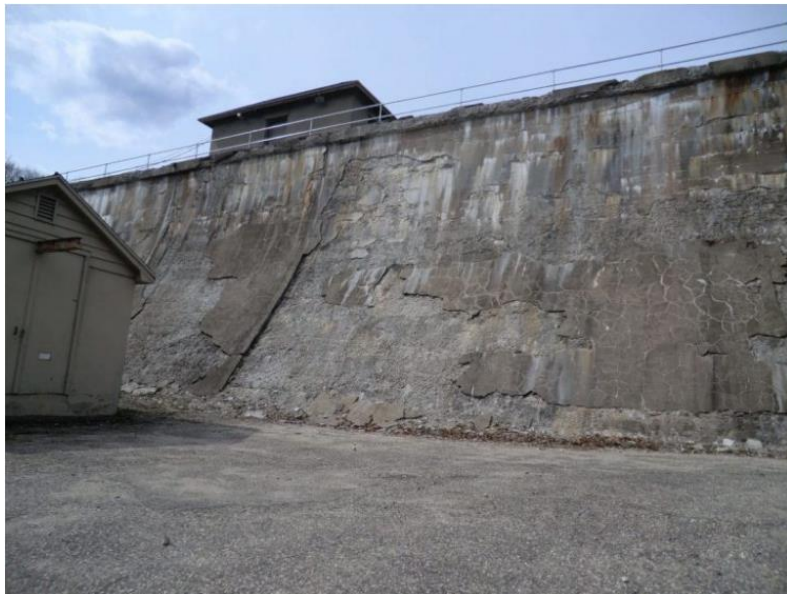
Figura 41: Deslocamento no concreto do paramento. Fonte: Tata & Howard, [201-].
