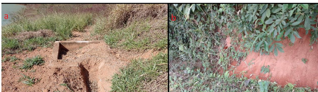
Figura 49: Obstrução dos dispositivos de drenagem: a) caixa de passagem e b) canaleta. Fonte: Acervo Feam.
