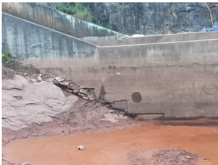
Figura 46: Parede externa do extravasor deteriorada. Fonte: Acervo Feam.
