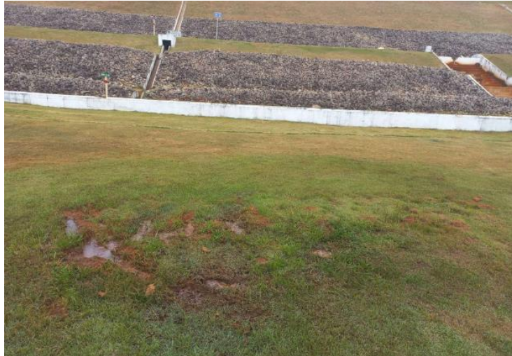
Figura 32: Surgência a jusante do pé de uma barragem de terra. Fonte: Acervo Feam.
