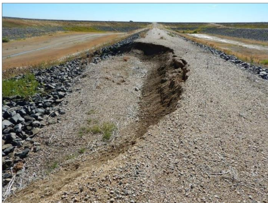
Figura 16: Ruptura de talude na barragem de Woman Creek (EUA), por perda de estabilidade do maciço. Fonte: ASDSO, [201-].
