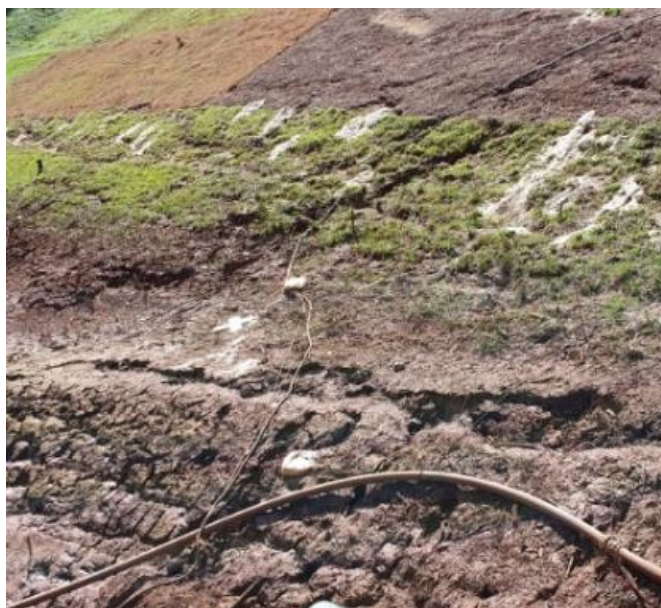
Figura 25: Trincas no talude do maciço de uma barragem de terra. Fonte: Acervo Feam.
