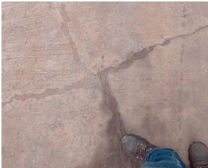
Figura 38: Fissuras por retração e abrasão na superfície da crista. Fonte: Acervo Feam.
