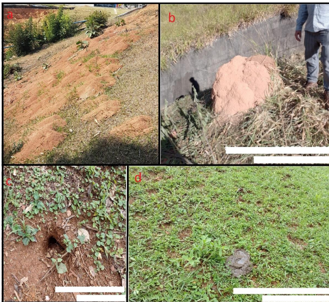
Figura 36: Atividades de animais nos maciços de barragens: a) ação intensa de formigueiros no talude de jusante; b) cupinzeiro no talude de jusante; c) toca de animal de pequeno porte; d) cavas superficiais devido ao transito de animais de grande porte. Fonte: Acervo Feam.
