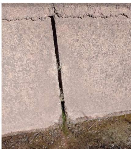
Figura 48: Junta de dilatação com abertura excessiva, com ocorrência de surgência de água. Fonte: Acervo Feam.
