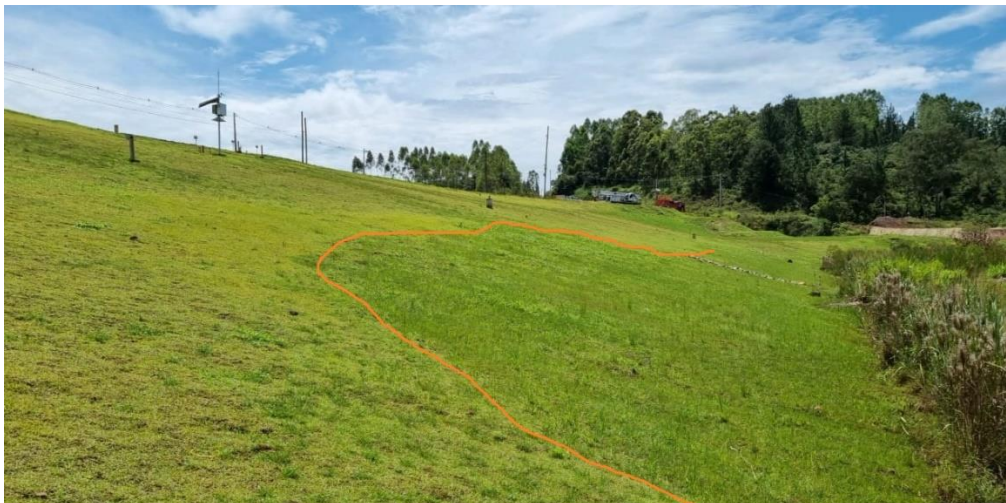
Figura 30: Indício de saturação na superfície do maciço, evidenciada pela diferença na coloração da vegetação mais próxima ao pé do talude.
