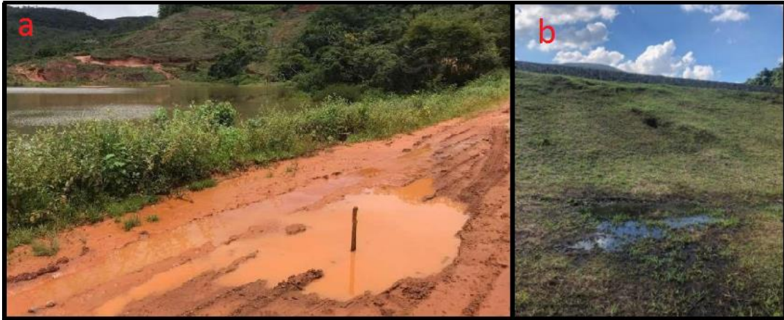
Figura 29: Acúmulo de água na superfície de barragens de terra na crista (a) e no talude de jusante (b). Fonte: Acervo Feam.
