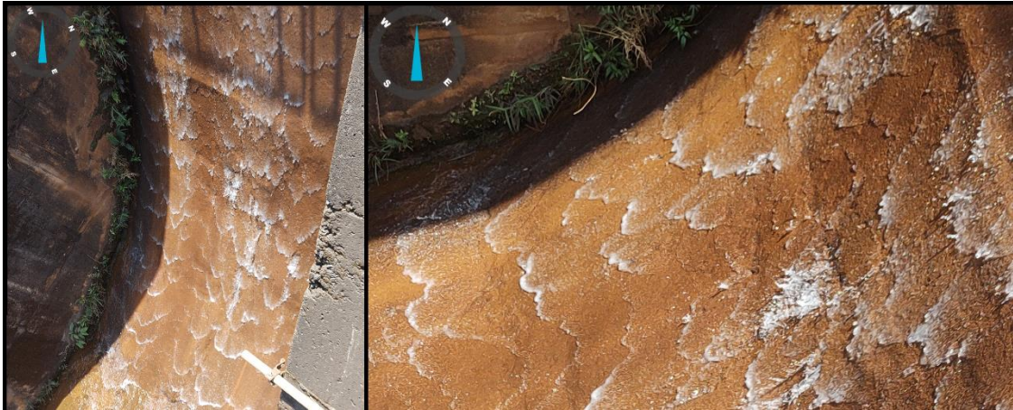
Figura 50: Ocorrência de cavitação no canal do vertedor. Fonte: Acervo Feam.
