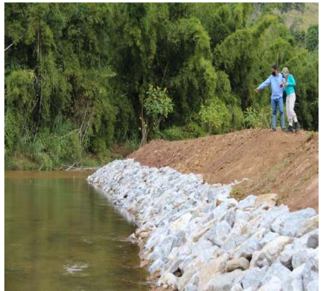
Foto 29: Detalhe do contraste entre turbidez da água do rio Gualaxo e do tributário e obras de enrocamento na margem do tributário
