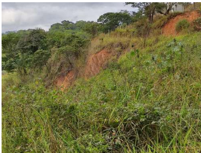
Foto 48: Talude com processo erosivo
