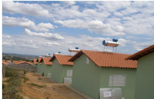
Figura 5: Instalação de aquecedores solares de água em um complexo residencial em Belo Horizonte (Fonte: ICLEI, 2010)
