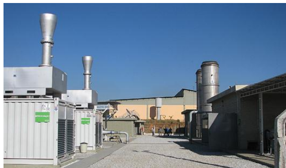
Figura 4 - Central de biogás do aterro BR040 (Fonte: Prefeitura BH portalpbh.pbh.gov.br )
