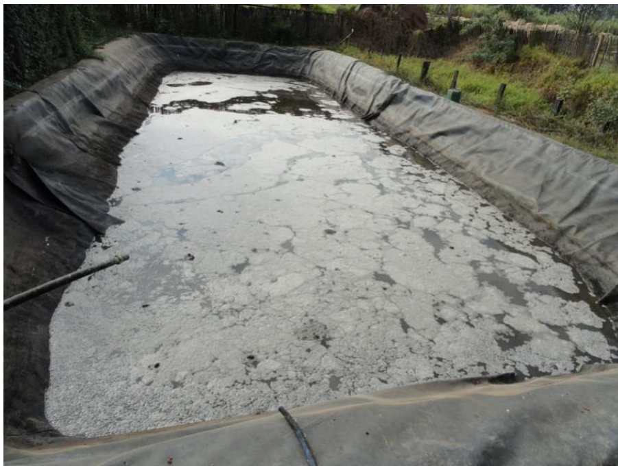
Figura 3-8 – Reservatório de vinhaça com geomembrana
