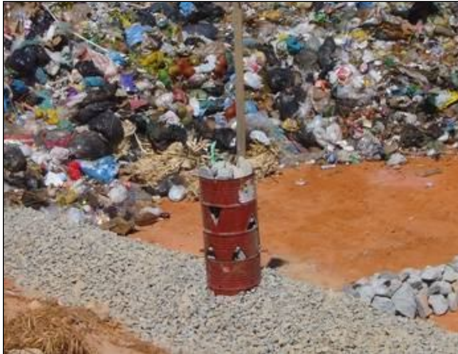
Figura 4: Vista da construção de um dreno de biogás interligado ao dreno principal de lixiviado.
