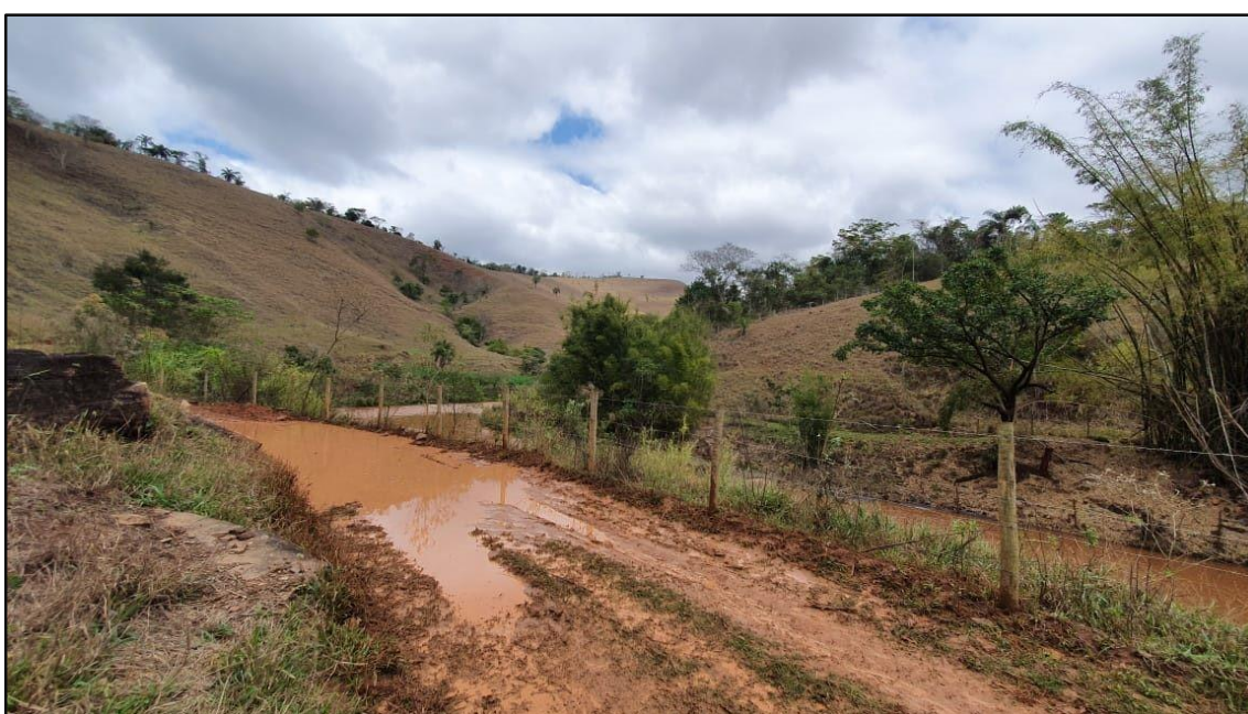
Foto 5: Via de acesso com acúmulo de água.
