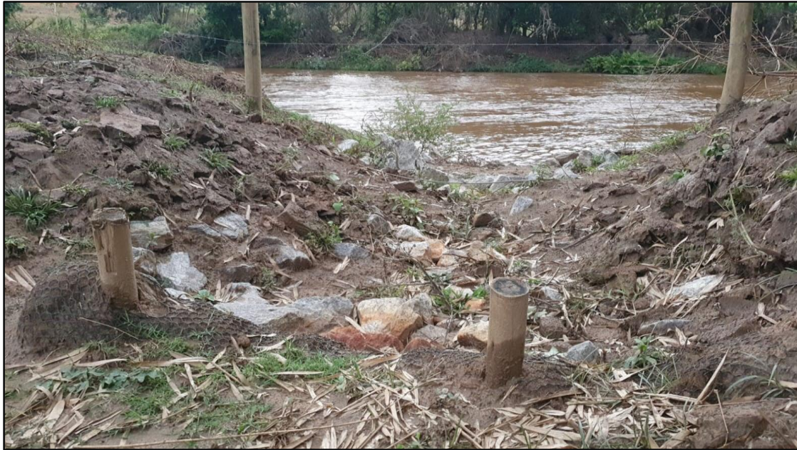
Fotos 3a e b: Revestimento da canaleta de drenagem com enrocamento, às margens do rio do Carmo.
