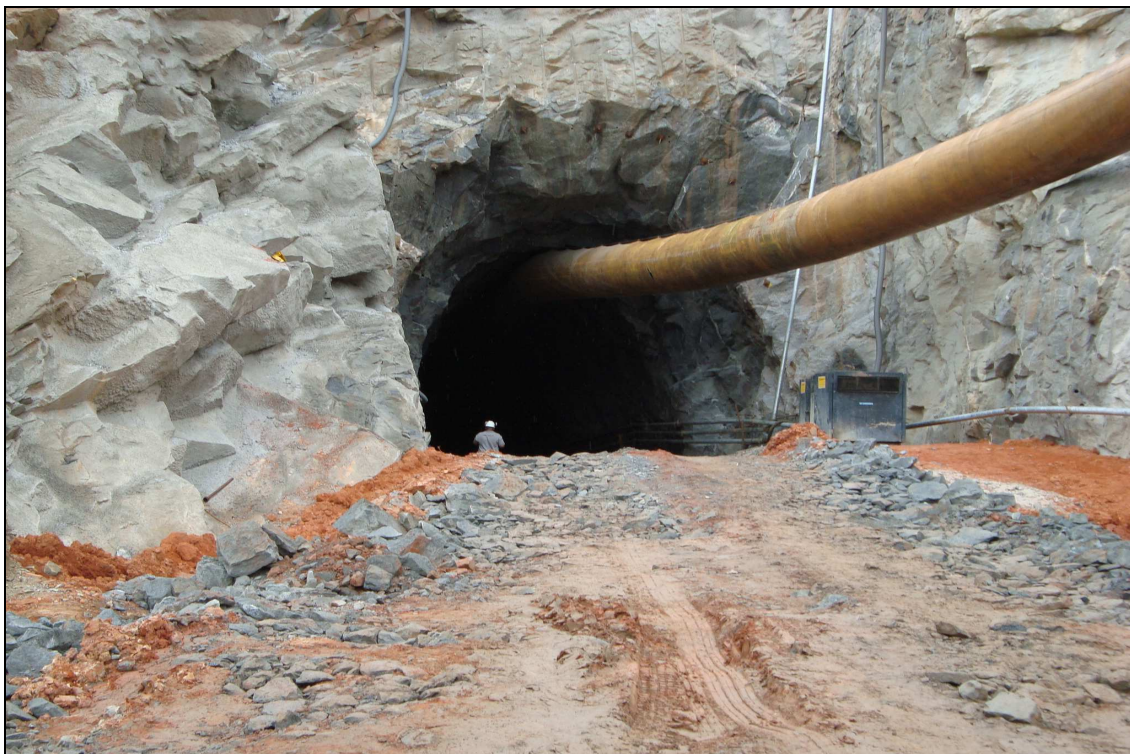
Figura 3: Tomada d'água do canal de adução
