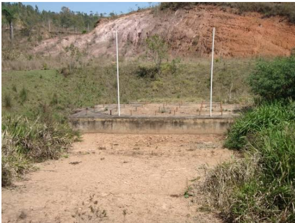
Figura 22 - Estação de tratamento de esgoto da sede municipal de Barbacena trata aproximadamente 5% dos efluentes.
