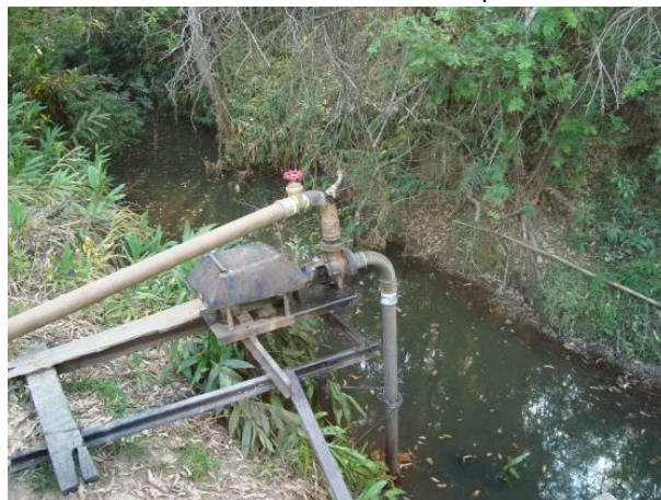
Figura 105 - Ponto de captação para o abastecimento doméstico e industrial da sede municipal de São João Del Rei, córrego Altamiro Braga.
