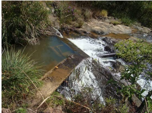
Figura 25 - Ponto de captação para abastecimento doméstico e industrial da sede municipal de Antônio Carlos.
