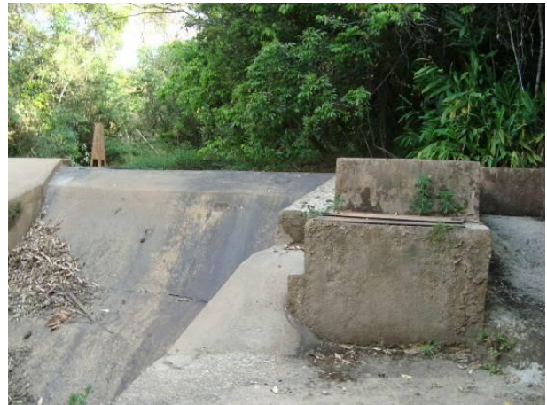
Figura 104 - Ponto de captação para o abastecimento doméstico e industrial da sede municipal de São João Del Rei, córrego Rio Acima.
