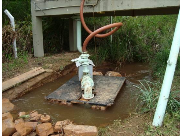
Figura 141 - Em destaque a captação para abastecimento doméstico do distrito Mercês de Água Limpa (São Tiago).
