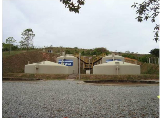
Figura 125 - Estação de tratamento de efluentes da sede municipal de Conceição da Barra de Minas.
