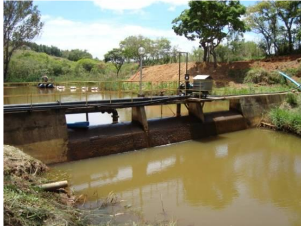
Figura 205 - Ponto de captação para o abastecimento doméstico e industrial da sede municipal de Santo Antônio do Amparo.
