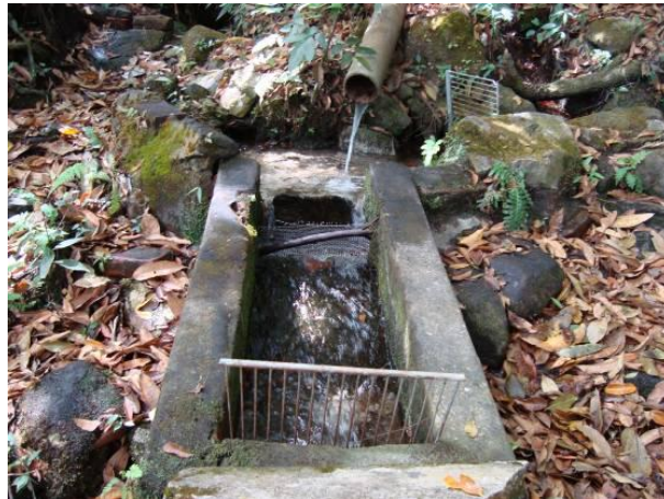
Figura 108 - Ponto de captação para o abastecimento doméstico e industrial da sede municipal de Santa Cruz de Minas.
