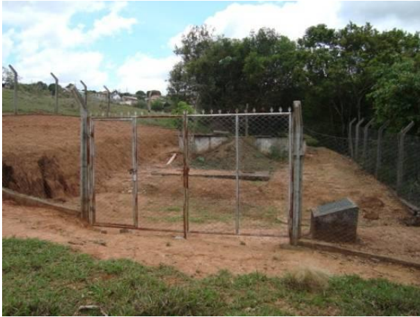
Figura 175 - Filtro para retirada dos resíduos sólidos provenientes dos efluentes domésticos do povoado rural Palmital do Cervo (Carmo da Cachoeira).
