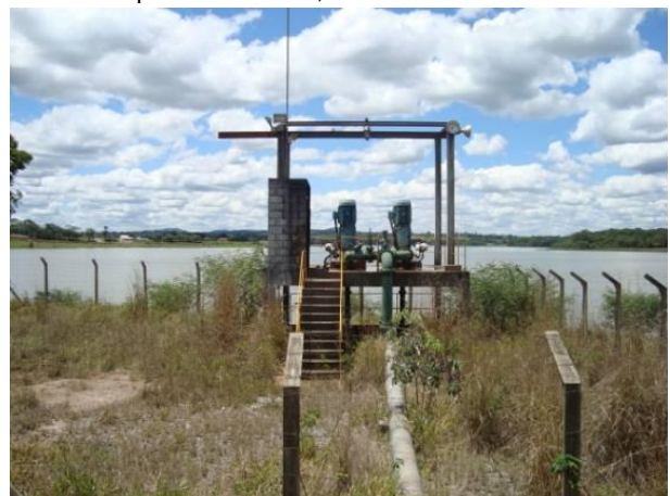
Figura 153 - Ponto de captação para o abastecimento industrial.
