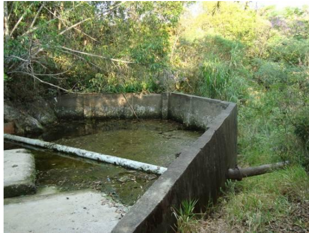
Figura 109 - Ponto de captação para abastecimento doméstico e industrial da sede municipal de São João Del Rei.
