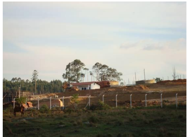
Figura 117 - Obras da estação de tratamento de esgoto da sede municipal de Resende Costa.
