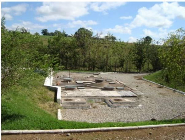
Figura 150 - Estação de tratamento de esgoto da sede municipal de Ijaci.
