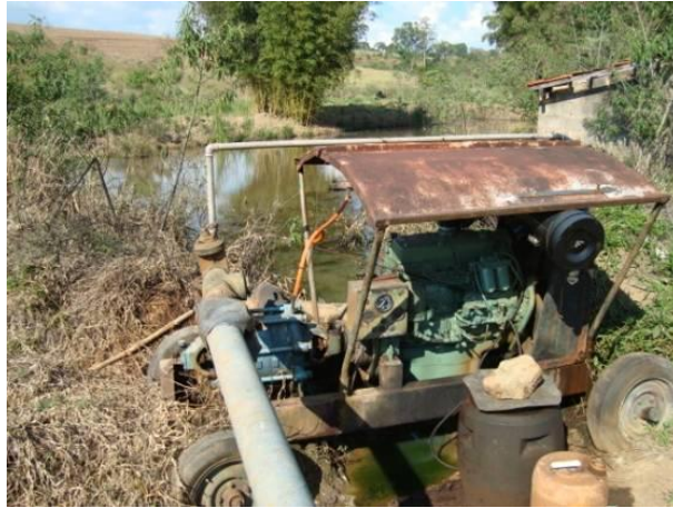
Figura 164 - Ponto de captação para irrigação por aspersão.
