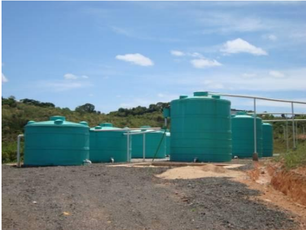
Figura 201 - Estação de tratamento de esgoto da sede municipal de Santo Antônio do Amparo.
