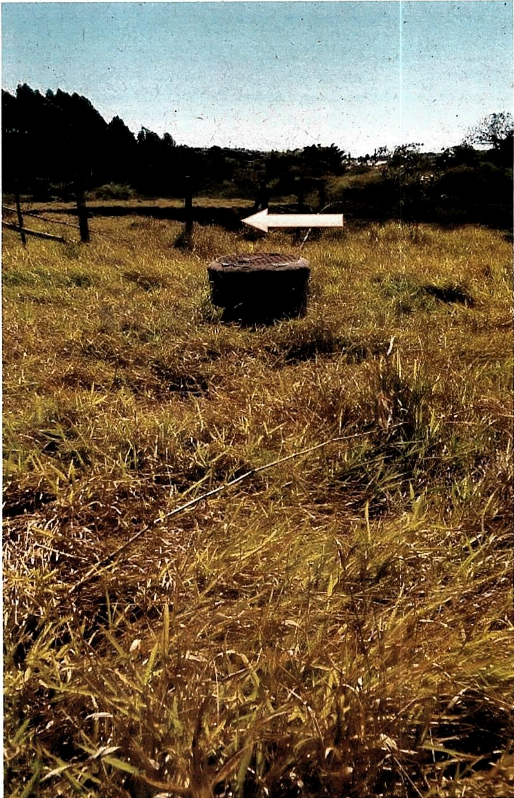
FOTO 05- Interceptor da rede de esgoto municipal próximo ao foco erosivo
