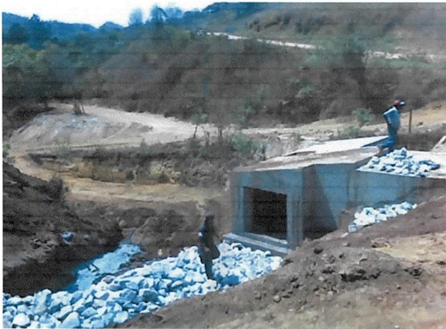
GALERIA SENDO IMPLANTADA COM REDUTOR DE ENERGIA D'ÁGUA, ACABANDO COM O ASSOREAMENTO
