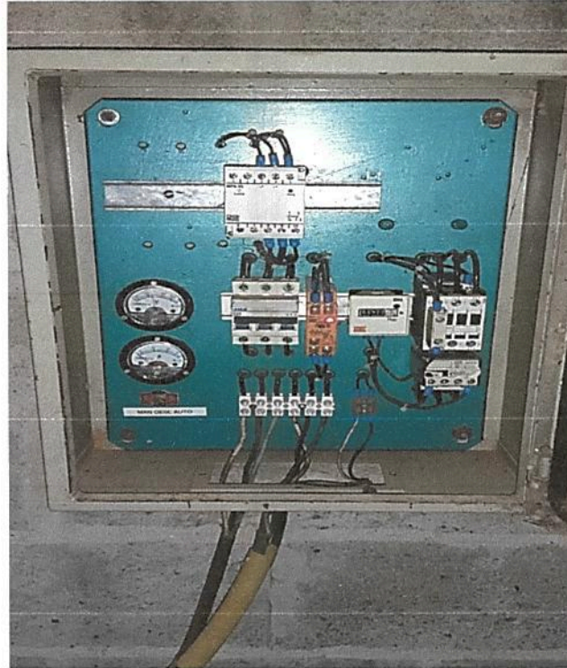
Foto 3 – Central de controle da bomba e Horímetro do poço tubular.
